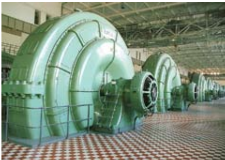
Vattenkraftverket Olidan, Göta älv. Fotograf: Hans Blomberg
