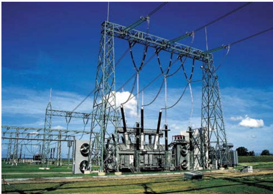
Transformatorstation, foto: Vattenfall
